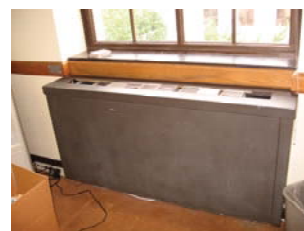
FAN COIL UNIT
