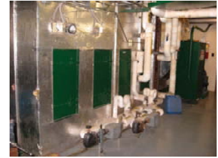
1938 FAN SYSTEM SF-1
